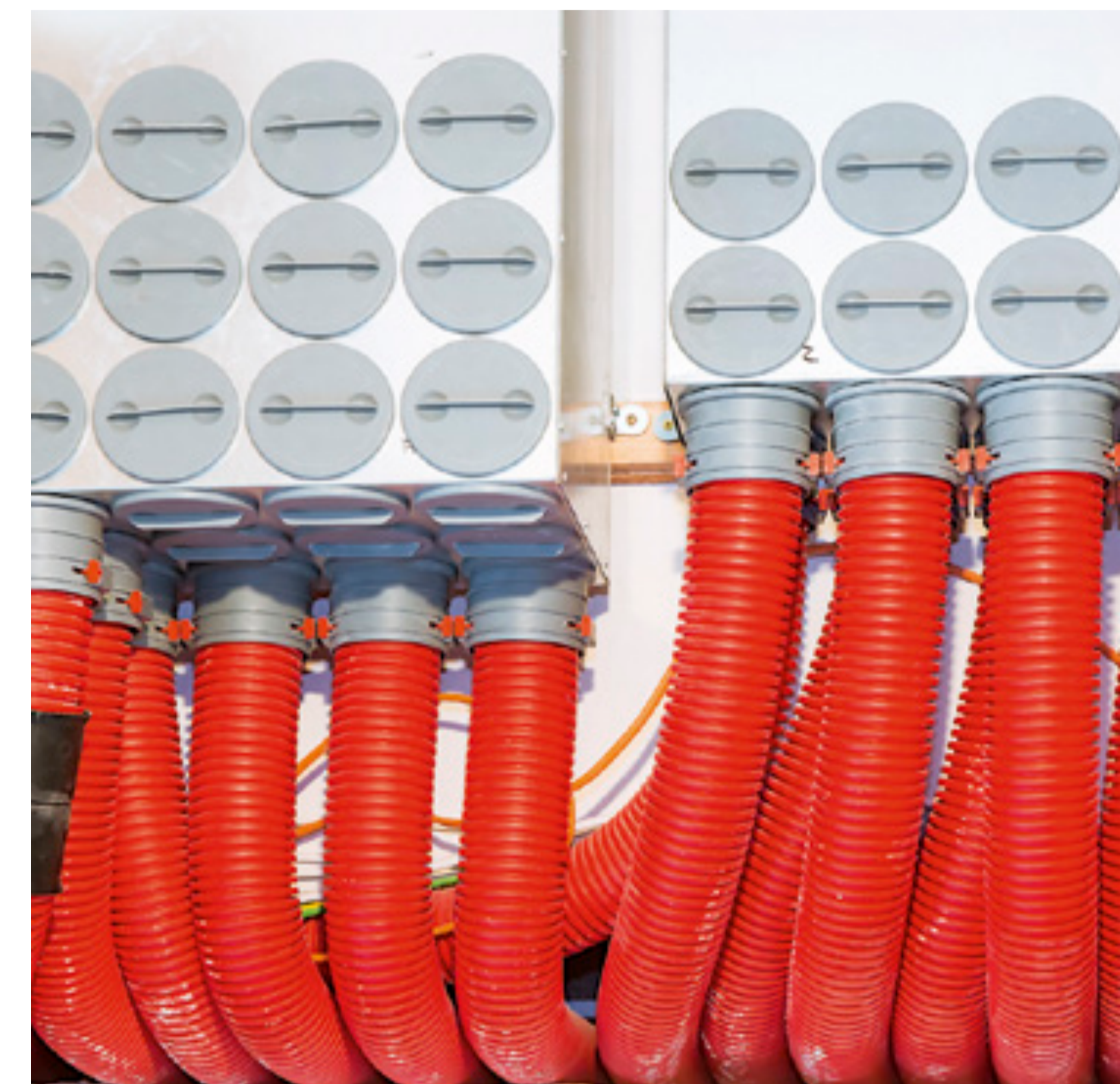
Згори донизу: Вигляд вентиляційної установки
