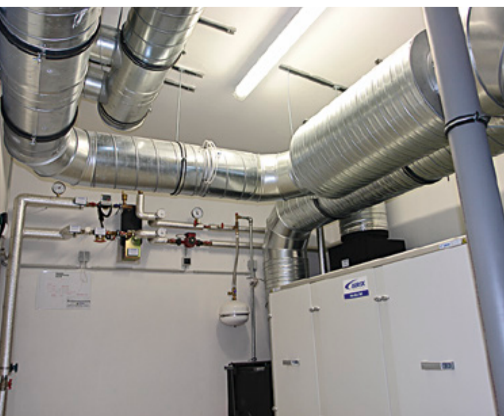
Повітряна установка для 15-ти житлових квартир
