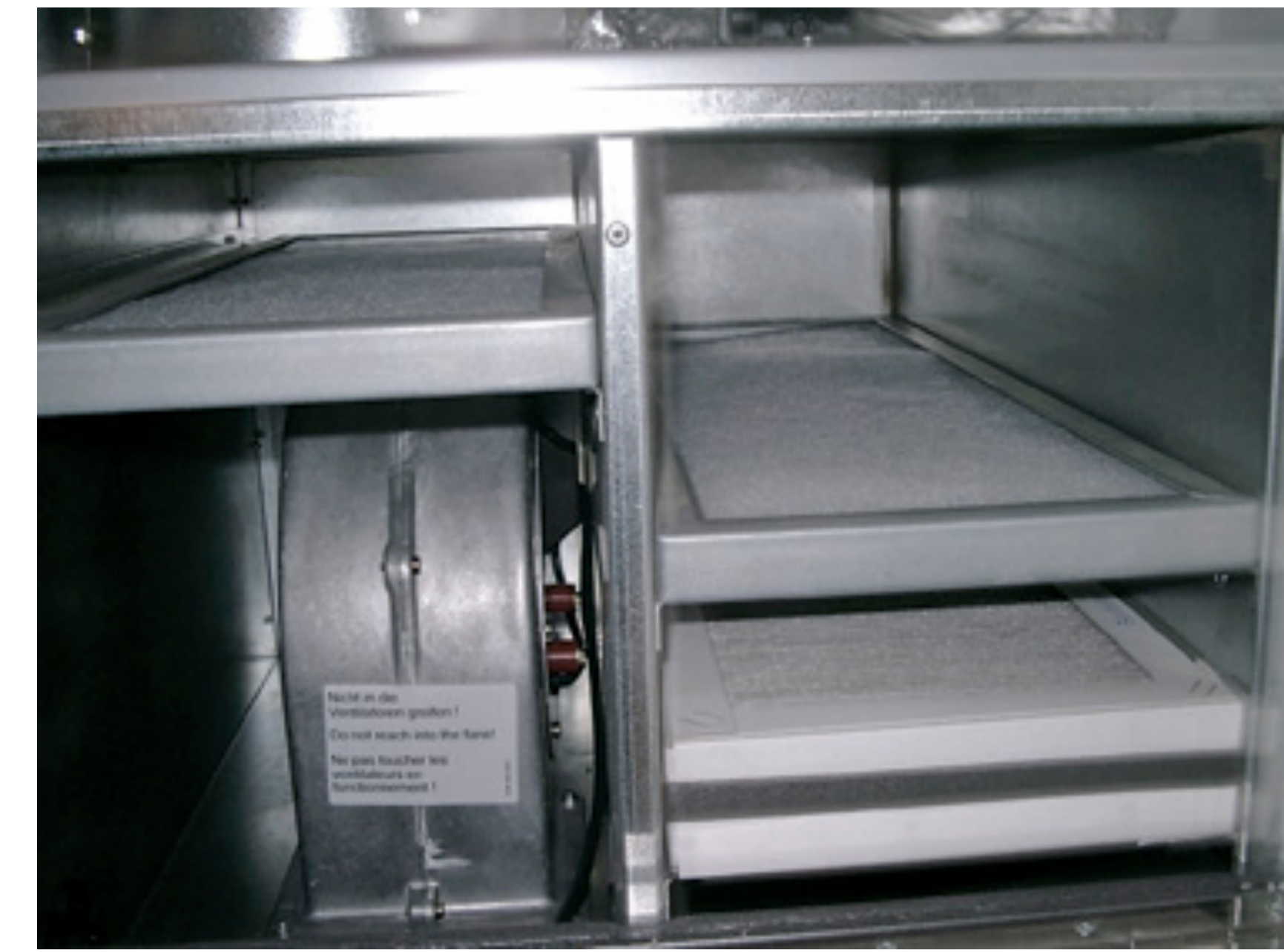
Фільтр в вентиляційній установці
