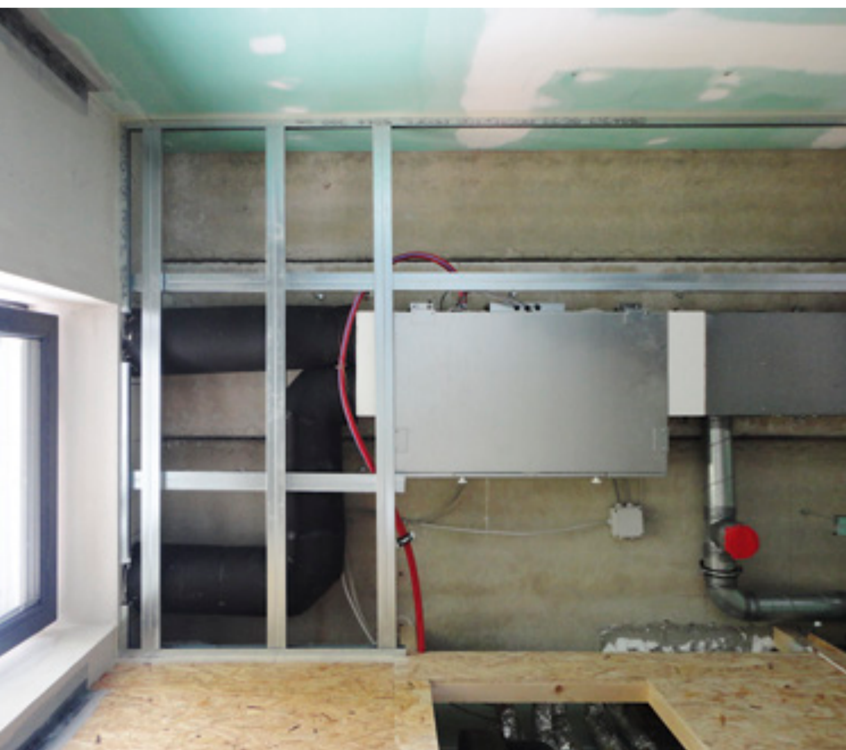
Вентиляційний блок та система розподілу під стелею
