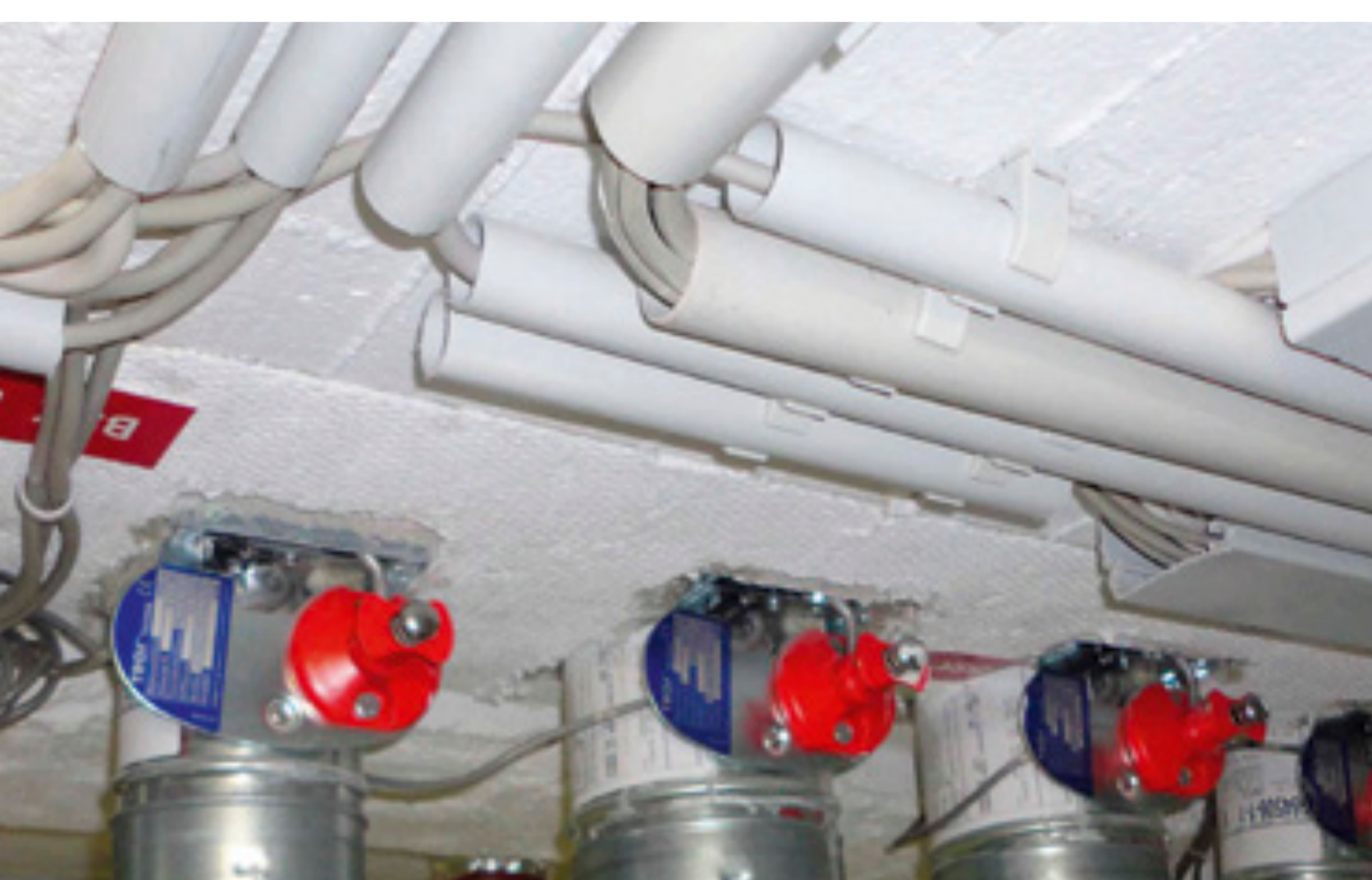
Згори донизу: Вентиляційні труби з протипожежною оболонкою
